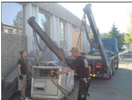
FARVEL: Det tok et år å bli kvitt ventilasjonsanlegget.
